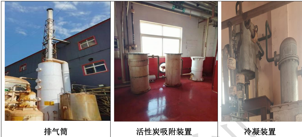
图 3.1-5 1-氨基蒽醌车间有机废气、酸性废气处理设施建设现状图
