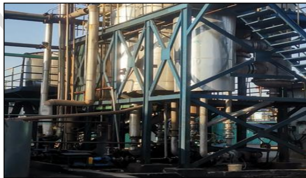
图 3.1-2 三效蒸发装置建设现状照片
