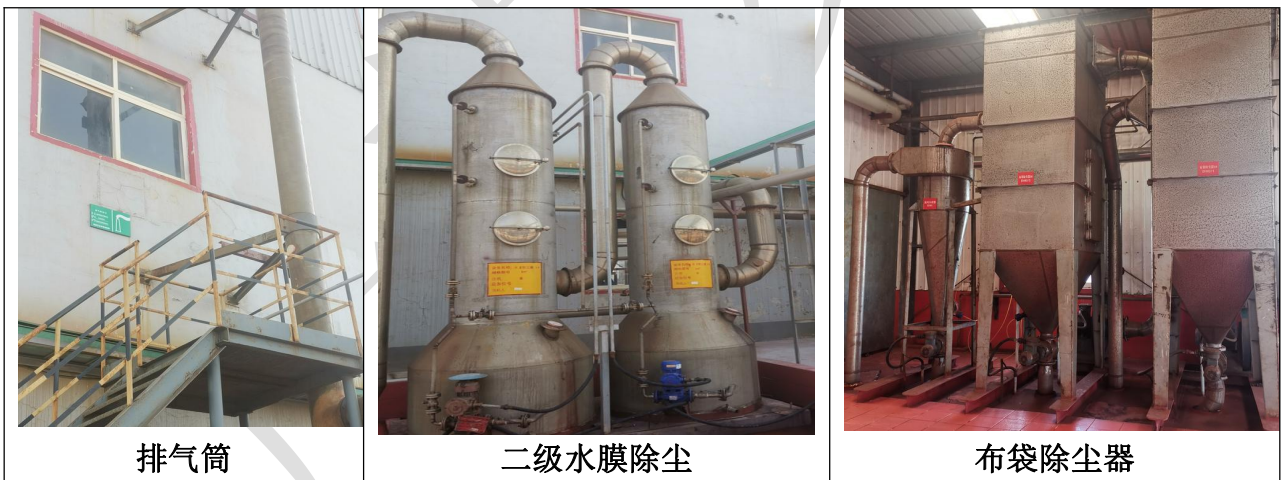
图 3.1-6 1-氨基蒽醌车间含尘废气处理设施现状建设图
