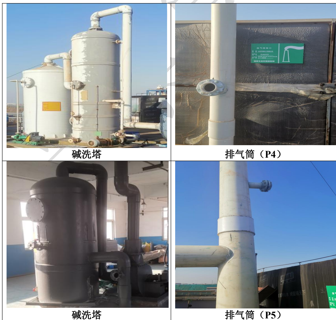
图 3.1-8 溶剂法铜酞菁车间酸性废气处理设施现状建设图
