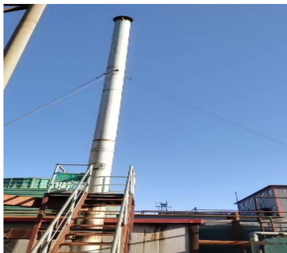
图 3.1-10 导热油炉排气筒建设现状图
